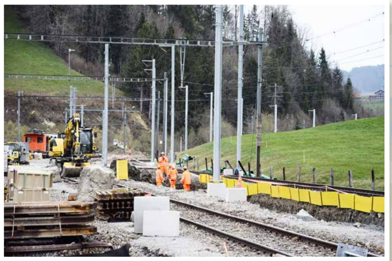
Für den Ausbau der Doppelspur wird der Bahndamm auf einer Länge von rund 200 Metern verbreitert.
